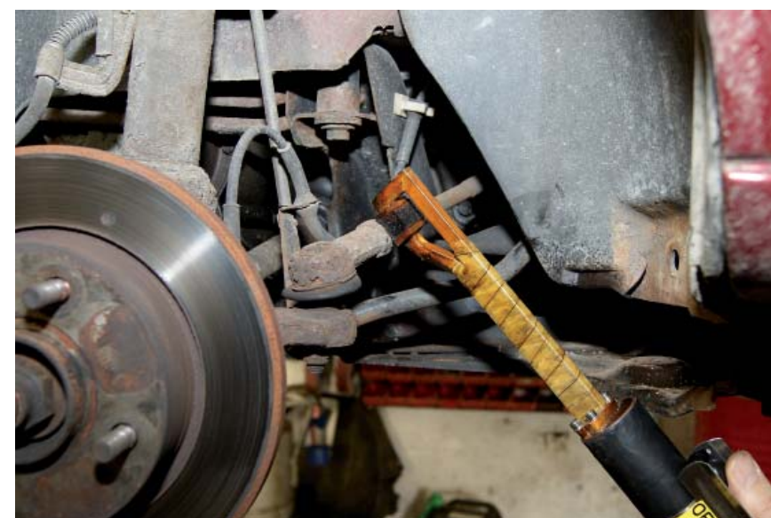
Oft ein Problemfall – eine festkorrodierte Kontermutter am Lenkgestänge. Mit dem Alesco A800 kann sie gefahrlos für das Materialgefüge zum Öffnen erhitzt werden
